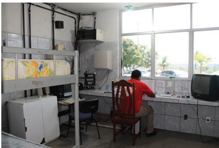
Bombeiro em serviço na sala da central telefônica
