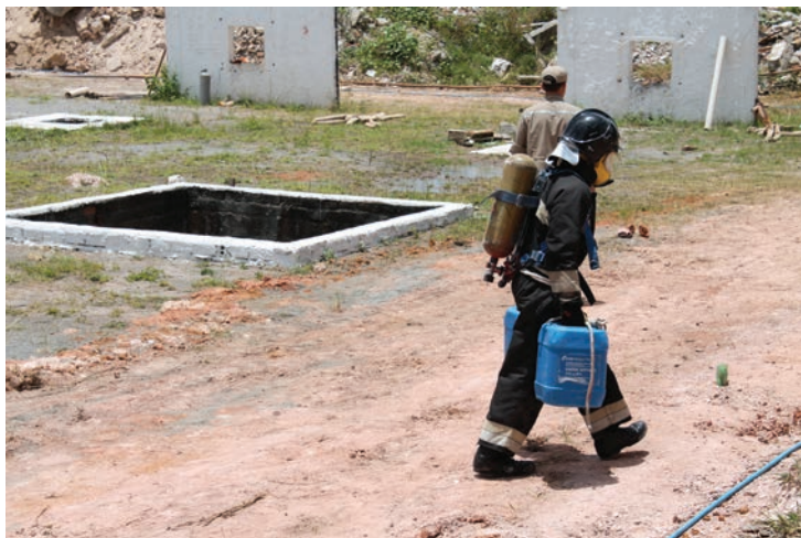
Roupa e equipamento de proteção para uso em tubulações e ambientes confinados
