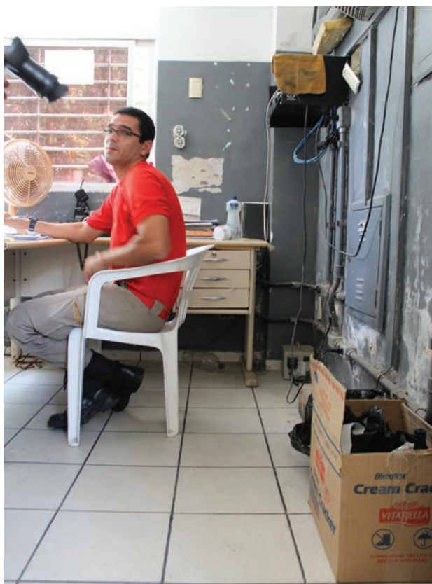
Infiltração e fiação exposta na sala da central telefônica
