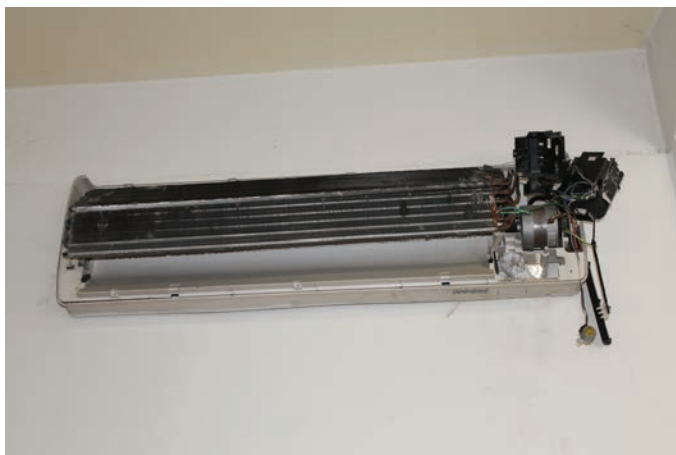
Aparelho de ar-condicionado sem funcionar no cassino do 2º GI
