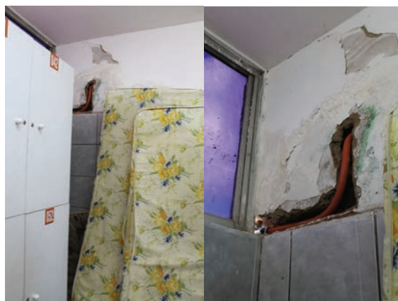
Colchões encostados na parede com buraco que expõe rede elétrica
