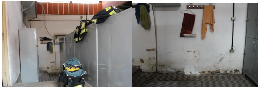
Roupas de aproximação e botas de segurança em rampa de concreto e local com infiltrações
