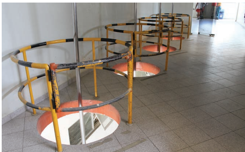
Quatro paralelas protegidas por um gradio com sinalização
