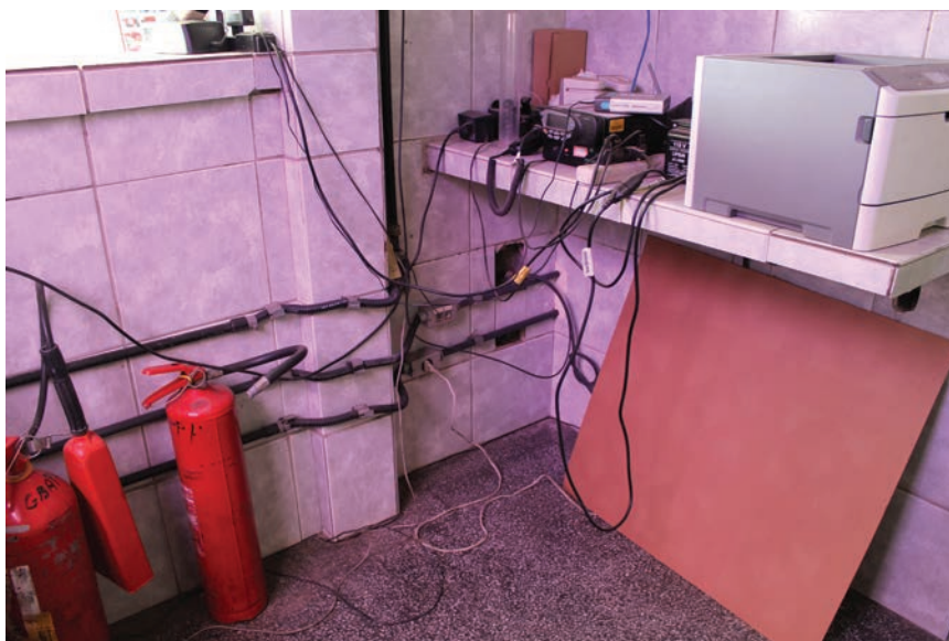
Fiação elétrica exposta e equipamentos eletrônicos
