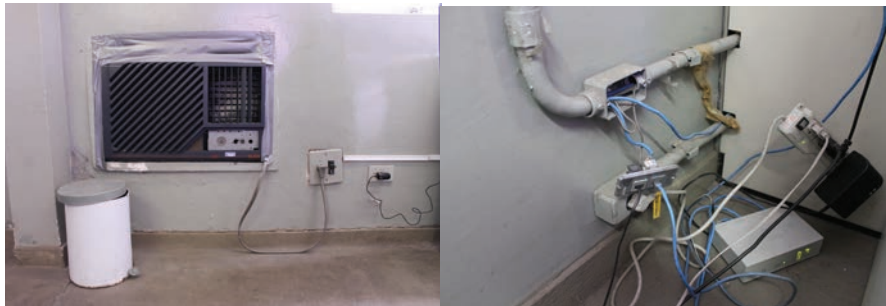
Aparelho de ar-condicionado e fiação elétrica e de internet da divisão de operações
