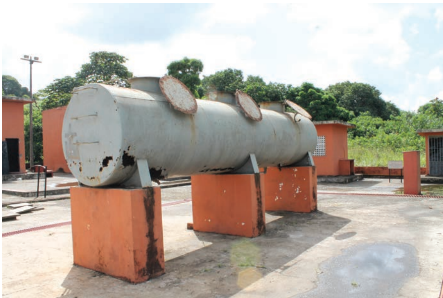
Estrutura que simula um tanque de combustível está enferrujada
