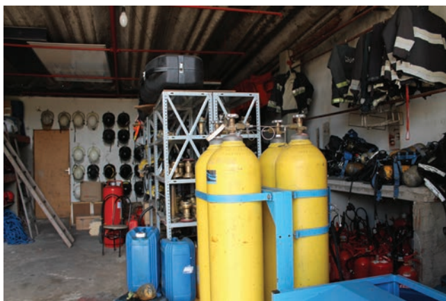
Equipamentos operacionais na sala do almoxarifado do Cemet II
