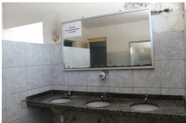
Infiltração e mofo no banheiro dos soldados do 2º GI
