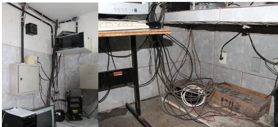
Emaranhado de fiação elétrica e de cabos de internet nas paredes da central telefônica
