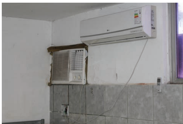
Instalação elétrica improvisada oferece risco
