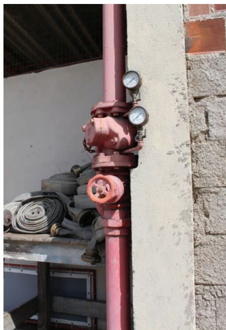
Registro da tubulação controla pressão do diesel no tanque de treinamento
