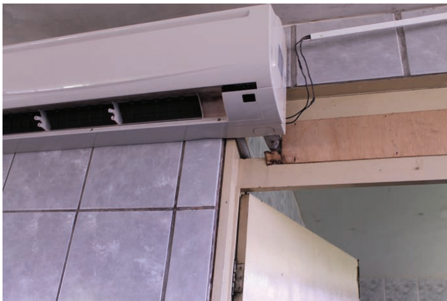
Instalação elétrica do ar-condicionado do alojamento de cabos e soldados
