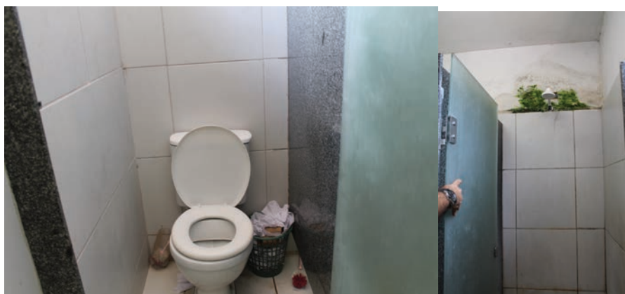
Banheiro tem box com infiltração, mofo e lixeira, transbordando de papel higiênico
