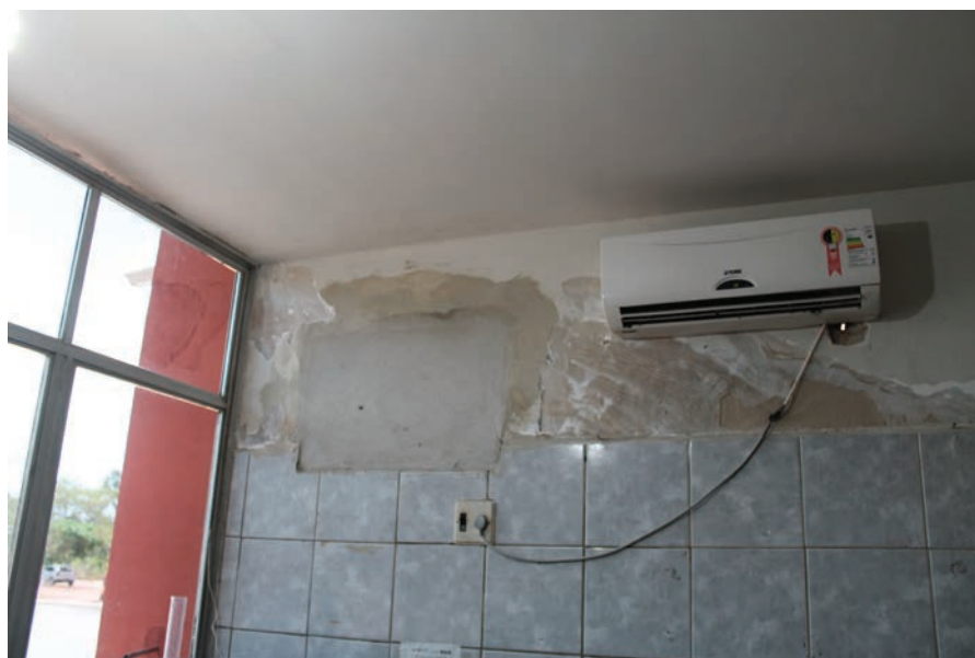
Cabo do ar-condicionado foi emendado e ligado à rede elétrica
