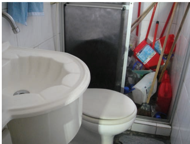
Banheiro feminino serve para armazenar objetos de forma aleatória
