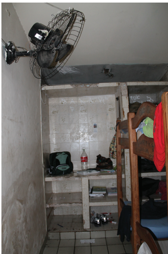
Quarto em mau estado de conservação
