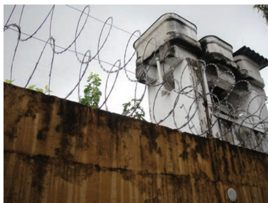
Arame farpado no muro e caixas d'água sem manutenção regular
