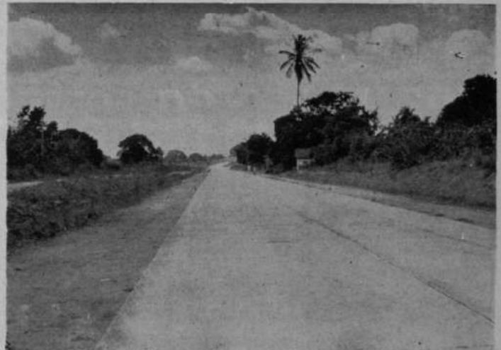
UMA VISTA DO TRECHO INAUGURADO — Uma vista parcial do trecho pavimentado Paudalho-Carpina entregue, sábado, ao tráfego público. Faz parte do Plano Rodoviário do Estado, e virá exercer papel preponderante no escoamento da produção pernambucana e de outros Estados vizinhos.
