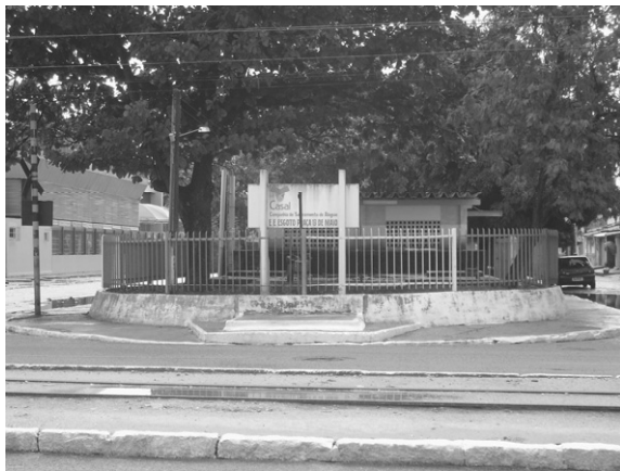
Figura 42 – Estação elevatória de esgoto na Praça 13 de Maio, Poço. Fonte: foto do autor, 2009.
