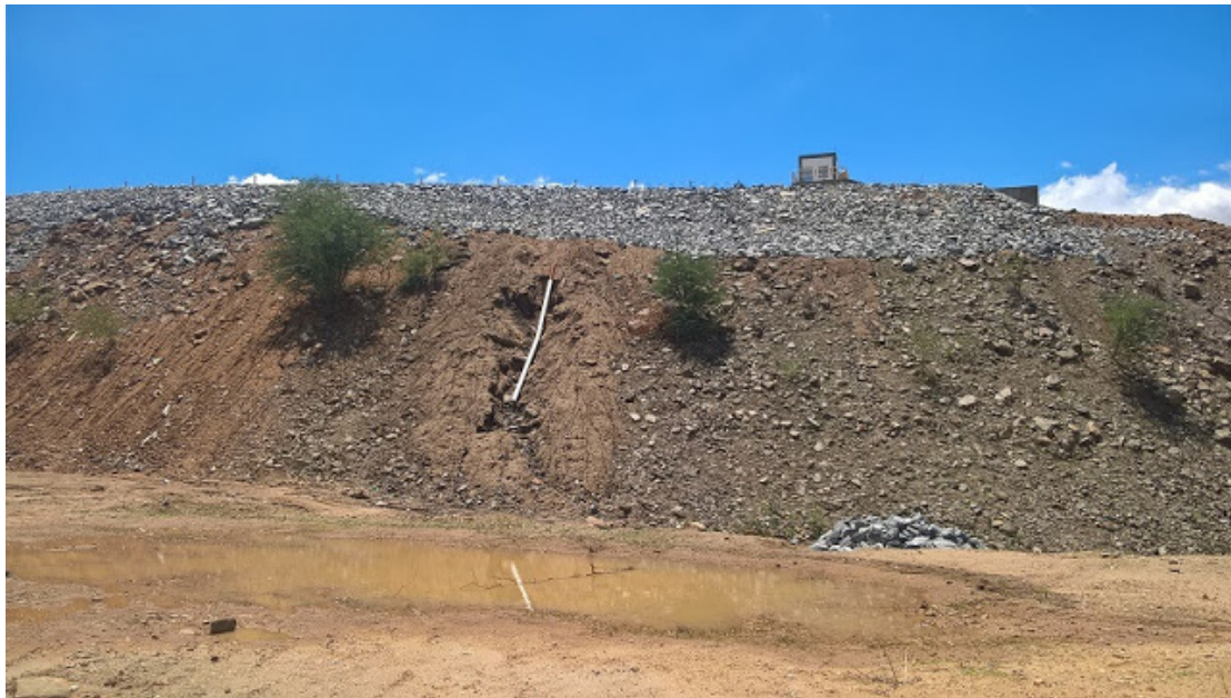
Erosão afeta aterro do canal que sai da EBV-5 mesmo com pouca chuva (Foto: Francisco Sarmento)
